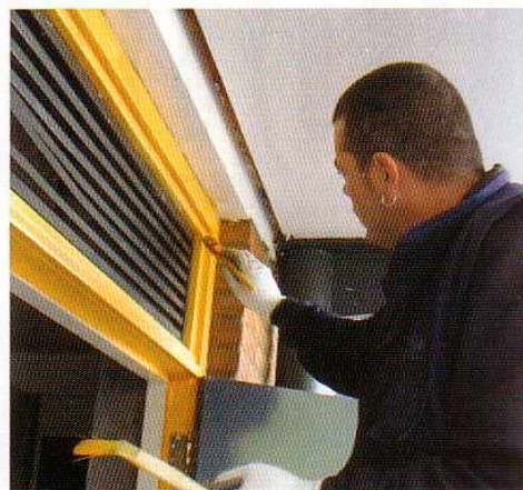
Gecombineerd onderhoud in samenwerking met een schilders- of onderhoudsbedrijf zou de slag om het behoud van het houten gevelelement kunnen zijn.
